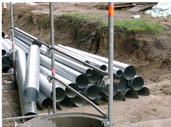
Abb.1: Luft als Lebensmittel transportiert in sauberen Rohren?
